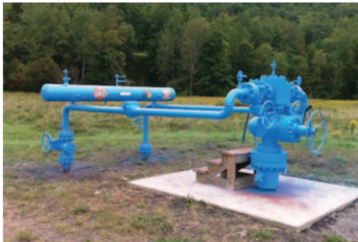
Głowica (tzw. wellhead), która zostaje zainstalowana, gdy odwiert jest przygotowany do produkcji.
