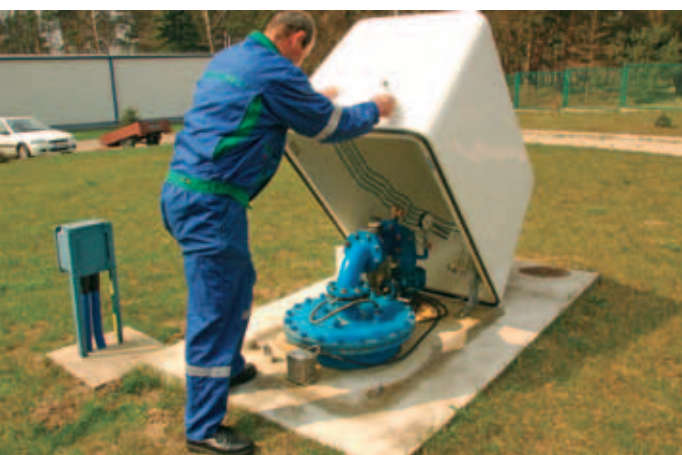
Jedna z 31 studni na ujęciu wody Czarny Dwór w Gdańsku
